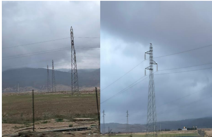
Figure 3.25 : les lignes électriques, source : P. prise par l'auteur
