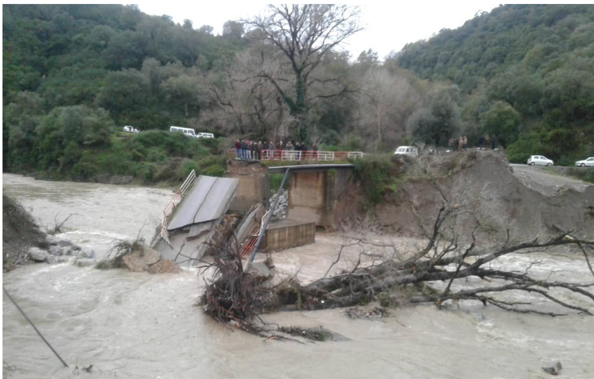
Figure 16 : Une photo réelle représentant l'effondrement du pont à Jijel en raison de l'érosion hydrique (www. jjeleljadida.dz ,2019)
