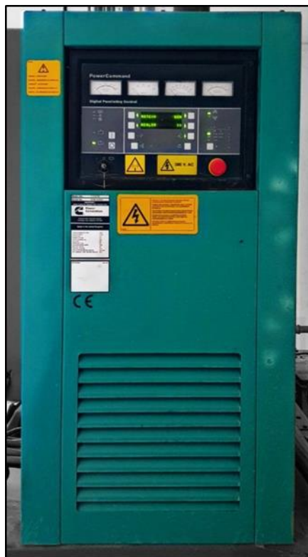
Figure IV-18 : L'armoire de commande et contrôle
