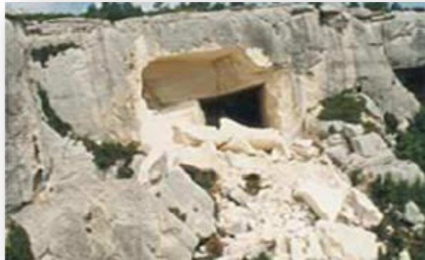
Photo I.7 : Rupture de surplomb. [18]
