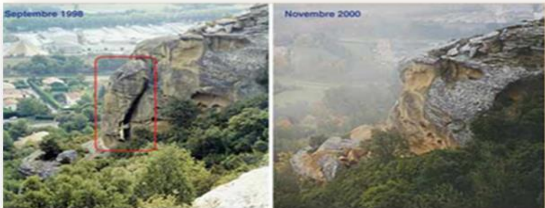
Photo I.8: Basculement d'une colonne par rupture du pied à lançon de Provence. [18]
