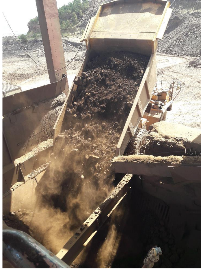
Figure IV.9 : déchargement de minerais dans la trémie de concasseur pour l'homogénéisation
