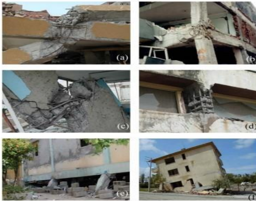
Figure I.6 Dommages subis par les portiques (a) : Rupture en zone de nœud d'ossature (b) : Rupture dans un poteau (c) Rupture de cisaillement dans un poteau (d-e) Rupture des poteaux courts (Séisme de Boumerdes du 21/05/2003) (f) : Effondrement du 1er niveau (Séismes de Bhuj 2001, Inde)
