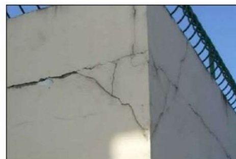
figure I.8. Fissures en treillis
