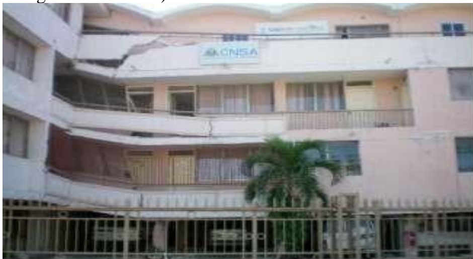
Figure II.5 : Exemple de dommage dû à l'irrégularité en (Structure irrégulière de forme).
