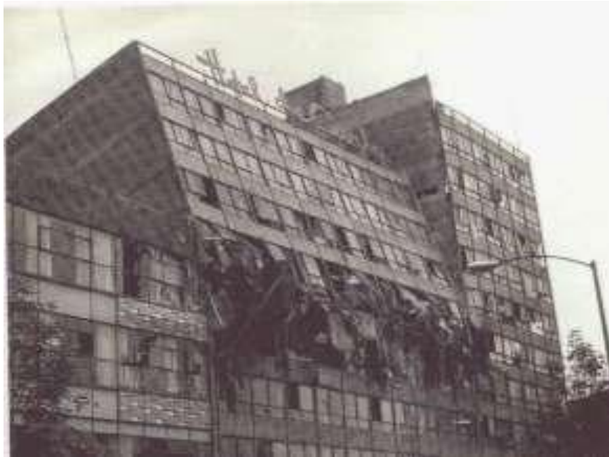
Figure II.8 : Exemple de dommage dû à l'irrégularité en élévation (Variation des géométries).
