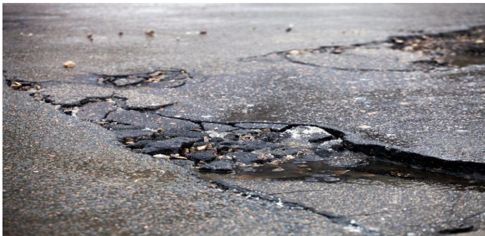
Figure 1.8 : Illustre des fissures sur la chaussée dues au soulèvement causé par le gel. [11]
