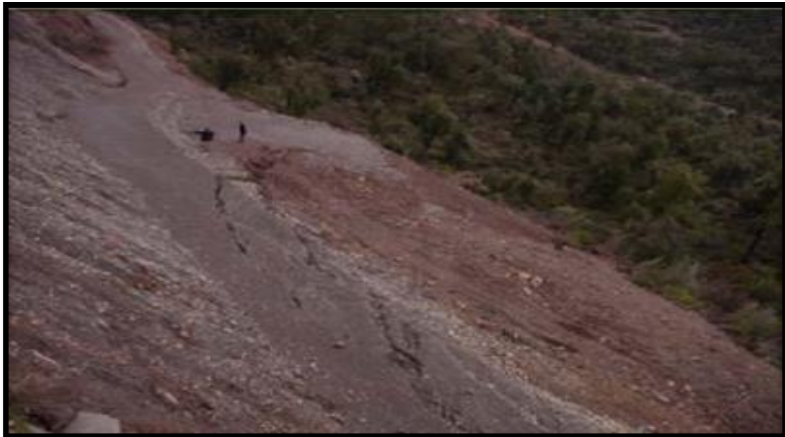
Figure I.21 : Fissures longitudinales dans la route affectée par le glissement [13].
