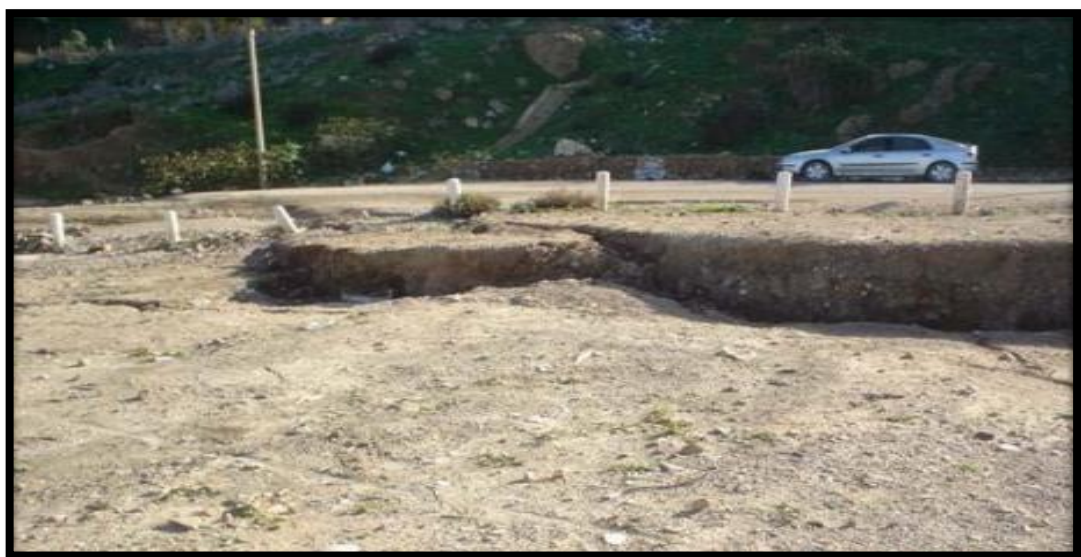
Figure I.24 : Affaissement de plus de 50 cm du glissement en bas du talus (Les Abattoirs Ténès) [13]
