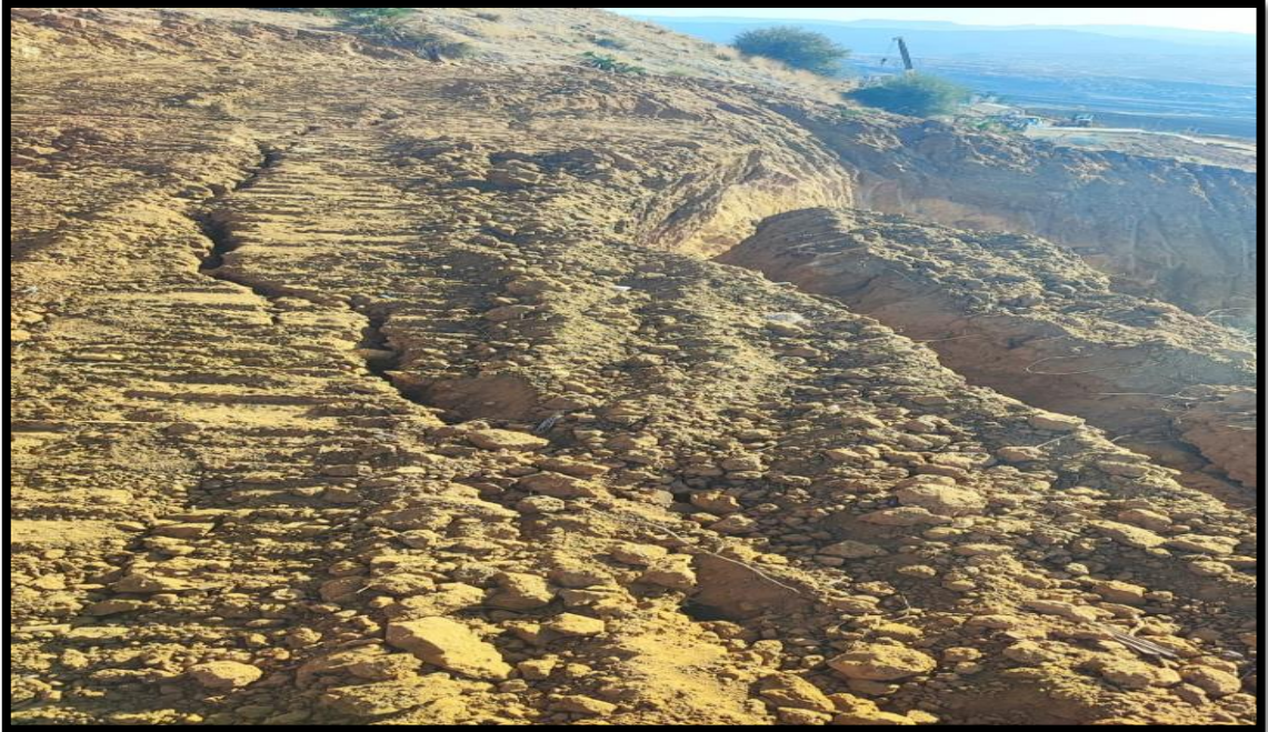
Figure I.27 : Des fissures de traction en tête.
