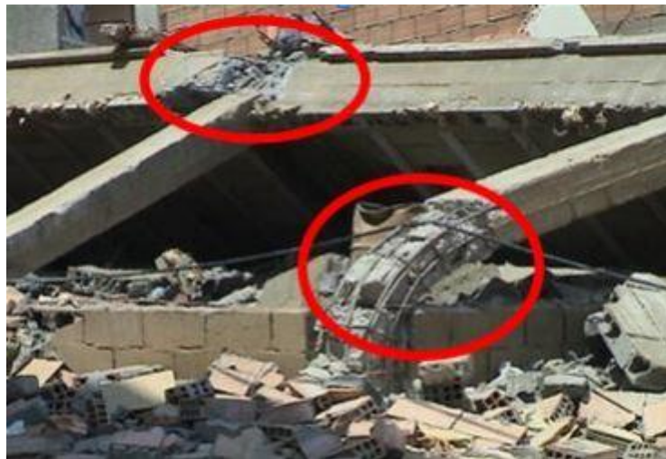
Figure III-5: Exemple de dommages d'un bâtiment après un tremblement de terre de Boumerdes 2003.[13]
