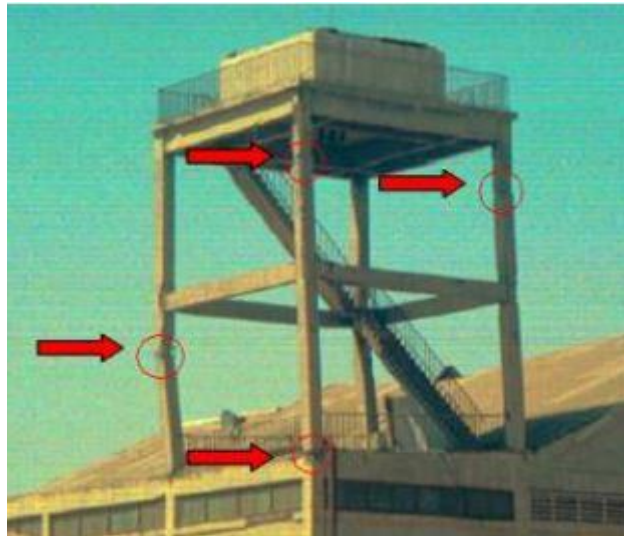
Figure III-6.: Endommagement d'un portique à 2 étages par flexion dans les zones critiques des poteaux dans une installation portuaire lors du séisme de Boumerdes 2003. [13]
