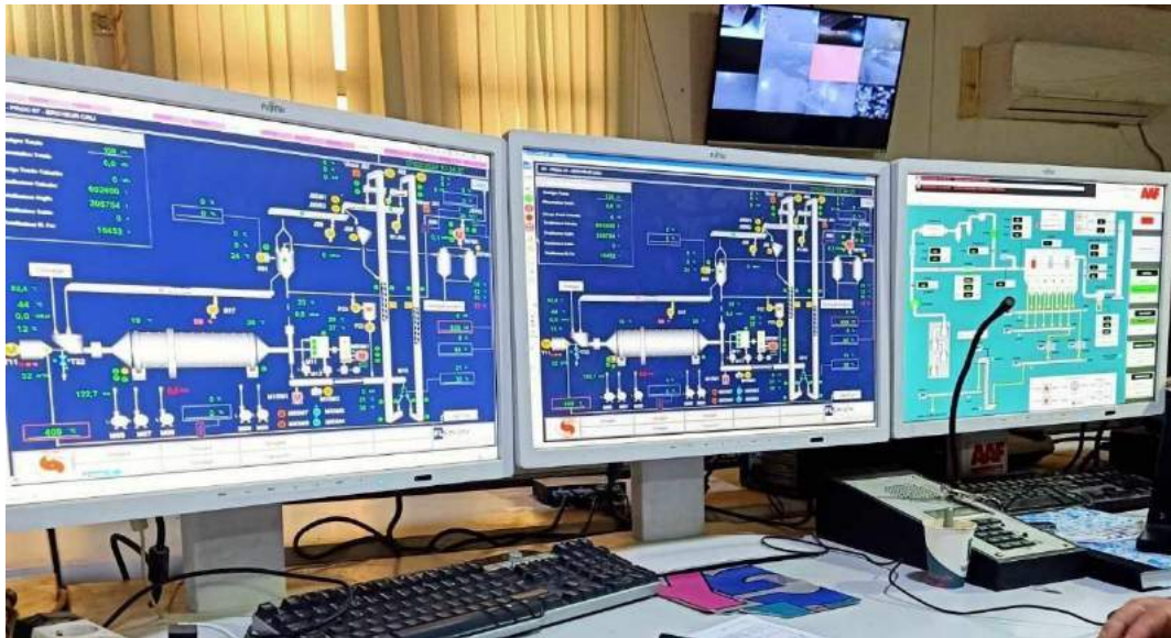
Figure 2.10 : Le poste de pilotage d'une supervision
