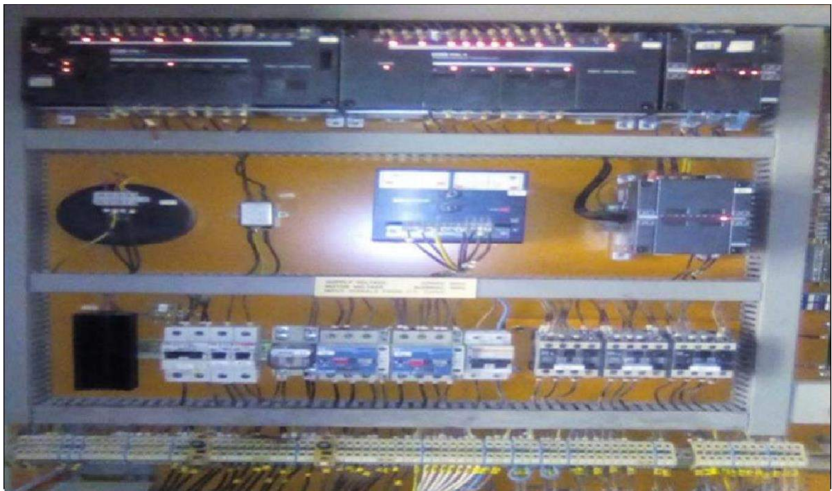
Figure 1.20 : L'automate utilise dans l'armoire [5]
