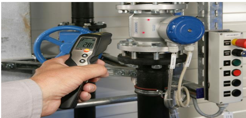
Figure II 7: mesure température par pyromètre
