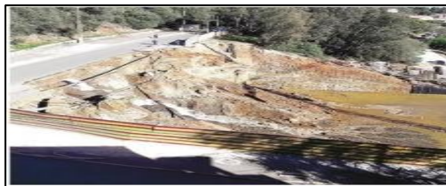
Figure I.21. L'effondrement de mur de soutènement à Bouzaréah
