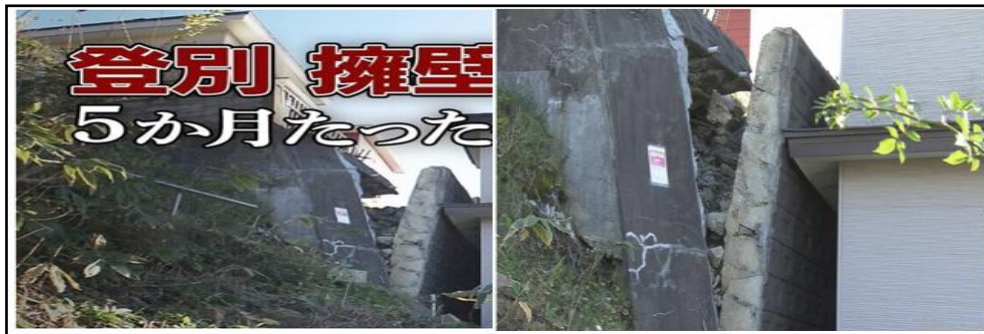
Figure I.20. L'effondrement du mur de soutènement de Noboribetsu
