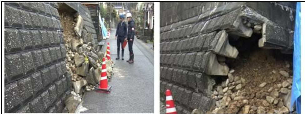
Figure I.22. L'effondrement de mur de soutènement à Tokyo
