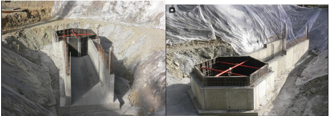
Photo N° 19 : Canal de fuite- micro centrale hydrolique
