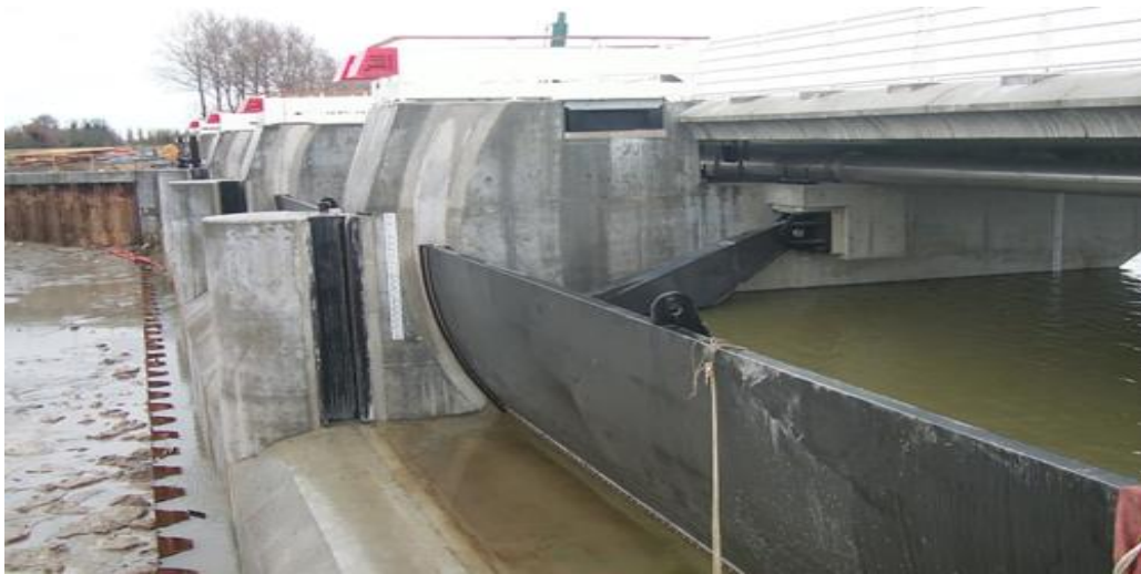
Photo N° 11 : Vanne segment. (Photo- INRAE - G2DR).
