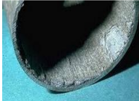
Figure I.7 : La corrosion inter granulaire
