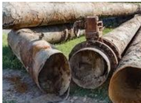
Figure I.8 : La corrosion sélective
