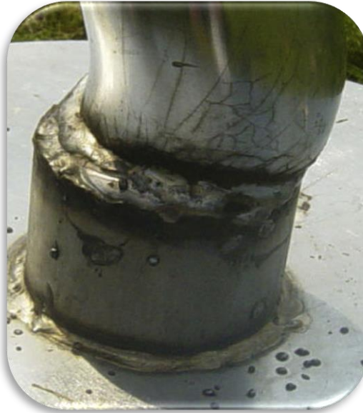
Figure 7 : Fissuration par corrosion sous contrainte de l'acier inoxydable austénitique
