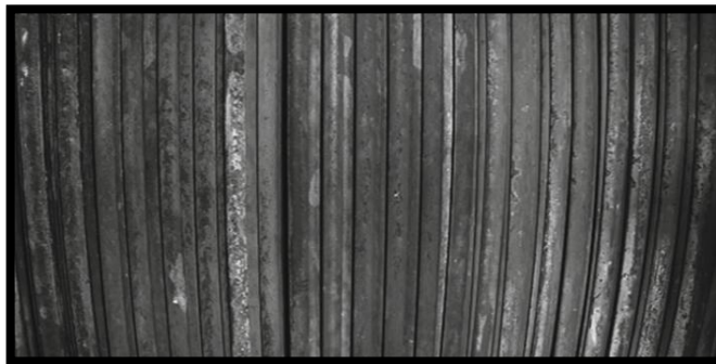
Figure I-1 : Un exemple de corrosion chimique, d'oxydation à haute température du tube de chaudière marine.
