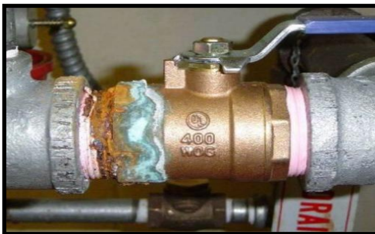
Figure I-10 : La corrosion galvanique d'un tuyau galvanisée.
