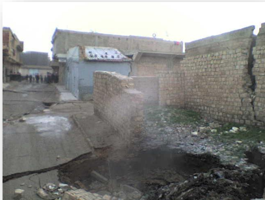
Photo 12 : Maisons et biens engloutis par une cavité, maisons fissurées
