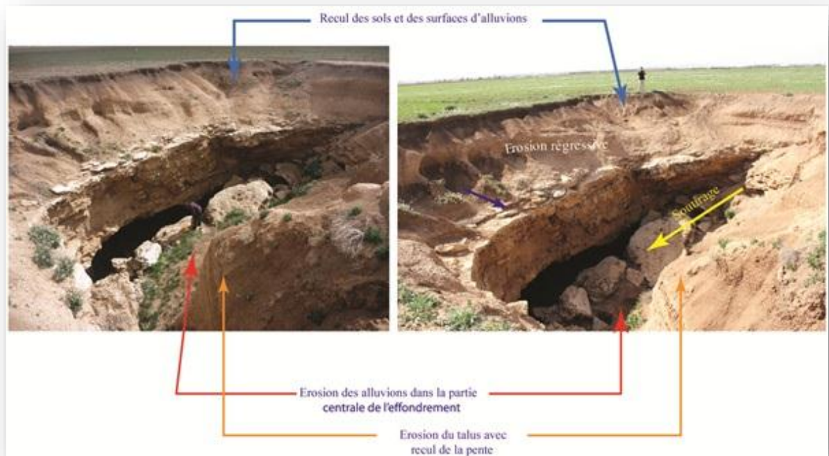
Figure 82: Erosion de la doline Ouest
