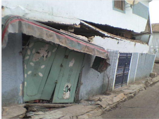
Photo 10 : Magasins et maisons effondrés
