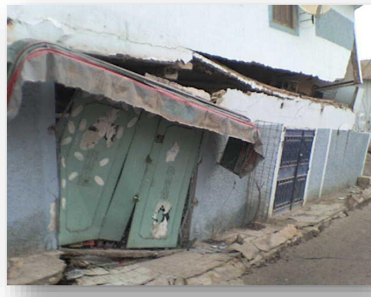
Photo 1,2, et 3 : Des effondrements, prises le 27Fevrier 2009
