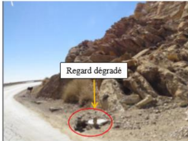
Figure 67: dégradation d'un regard.
