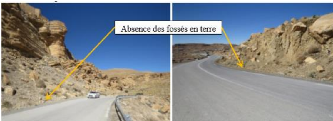
Figure 64: Absence des fossés en terre
