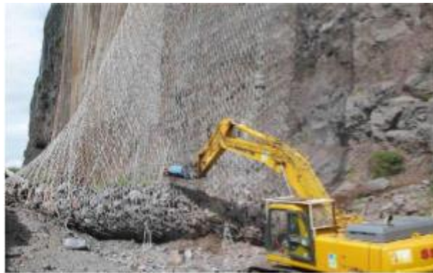
Figure 54: Exemple de grillage pendu après l'éboulement.
