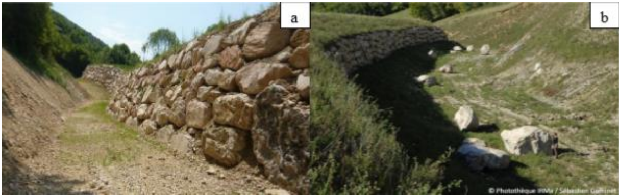
Figure 56: Exemple de Merlon pare-blocs (a. Avant l'éboulement, b. Après l'éboulement).
