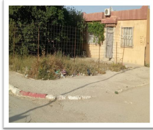
الصورة 9 . توضح حالة الأرصفة
