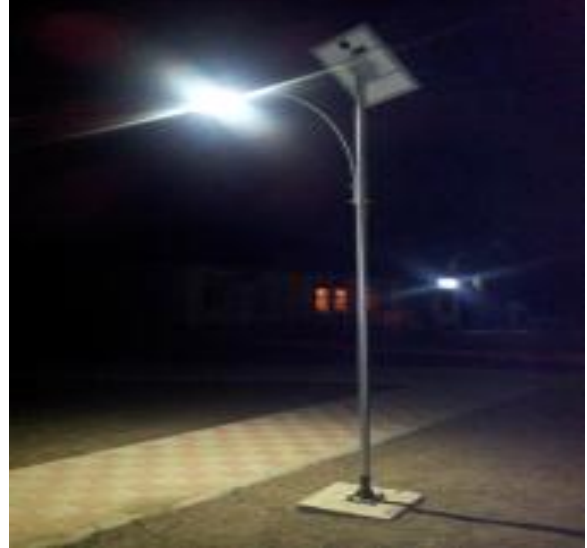
الصورة. 33: الاعمدة الكهربائية المتواجدة في الحي
