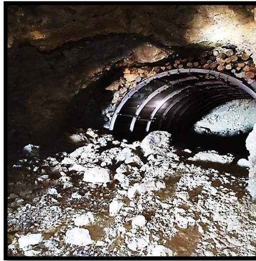
Figure 18 : Zone d'éboulement instable soutenu par un cintre métallique.
