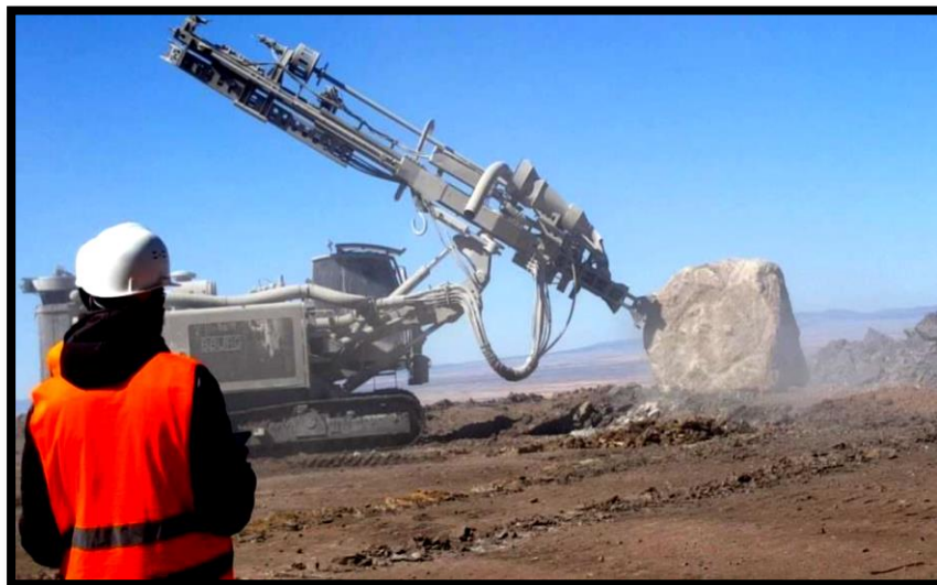
Figure 3 : La sondeuse BBURG HD 1500D utilisé pour les travaux de forage au niveau de la mine de Boukhadra.
