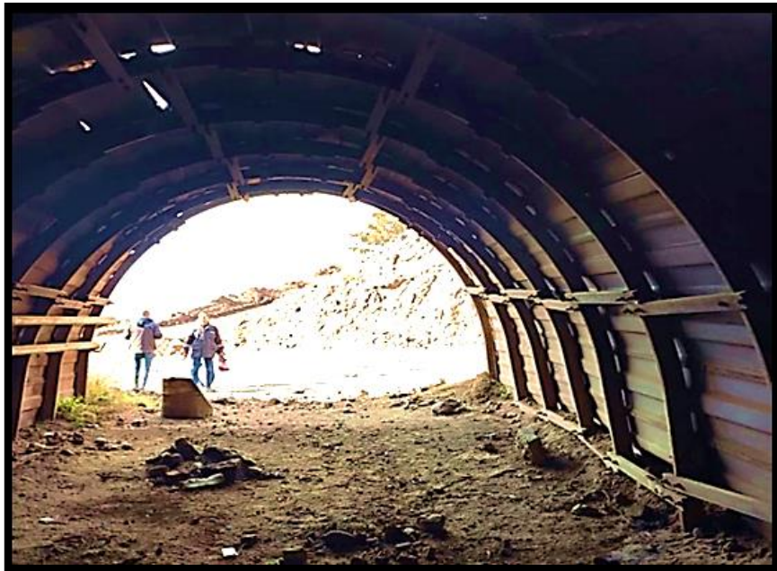
Figure 16 : Le soutènement de la galerie de la 4 ème phase.
