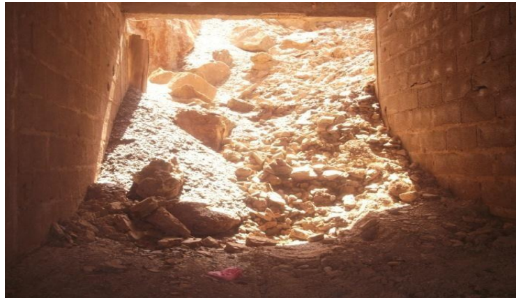
Figure II.02 : L'effondrement du toit de la galerie du filon N° 10 niveau 1855 m.
