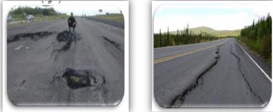
Figure I.18 : Dégradations de chaussées [14]
