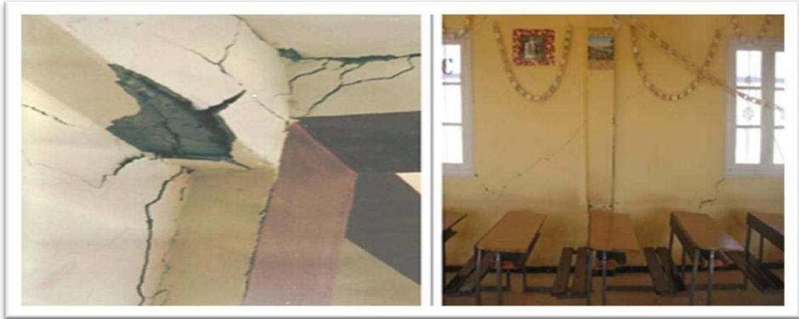
Figure 1.22 : fissuration des poutres et des murs à Ain Hadjel.[52]
