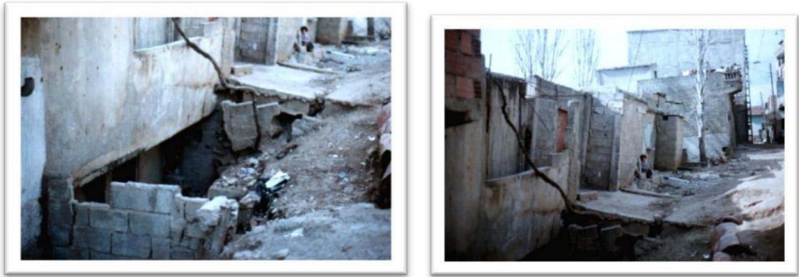
Figure 1.24 : Vue partielle d'un alignement de constructions ayant subi des basculements À Boudraa Salah[52]
