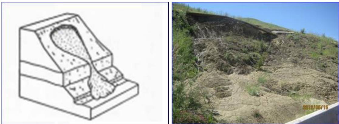
Figure I.14 : Exemple d'un coulé boueux section M5 (Projet Autoroute Est-Ouest).
