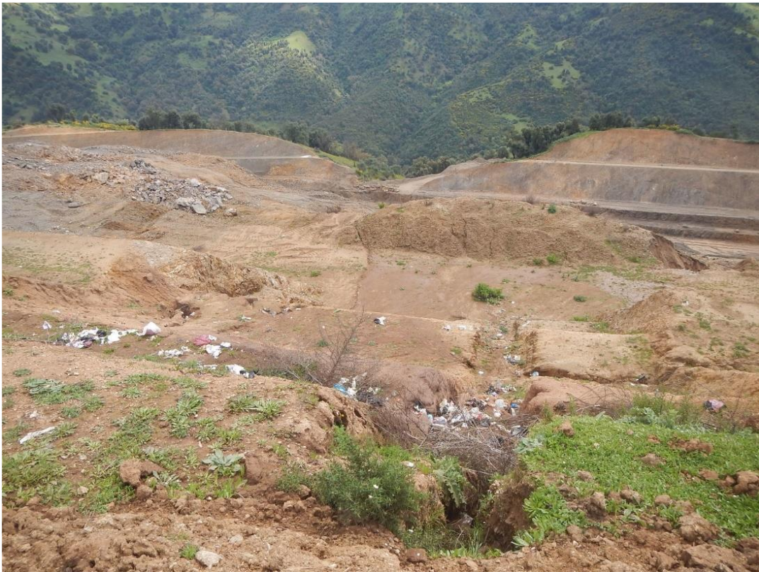
Photo III. 9 : vue de la sortie des fissures au niveau de la troisième berme.
