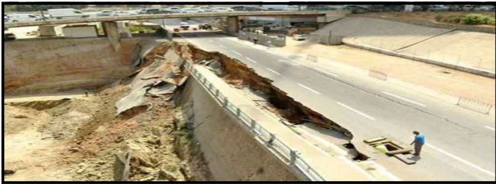
Figure I.14 : glissement de la route de port Oran 2016
