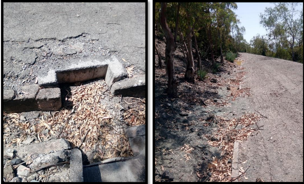
Figure II.18 : Colmatage des caniveaux
