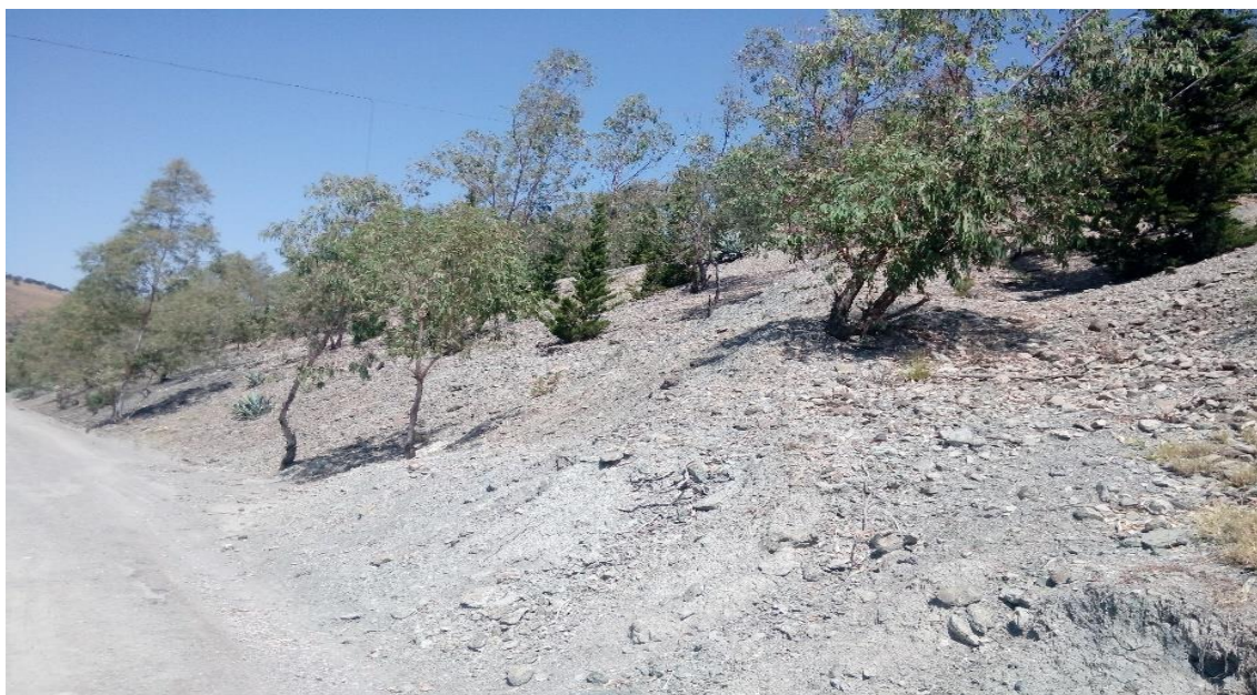
Figure.04 : érosion des talus
