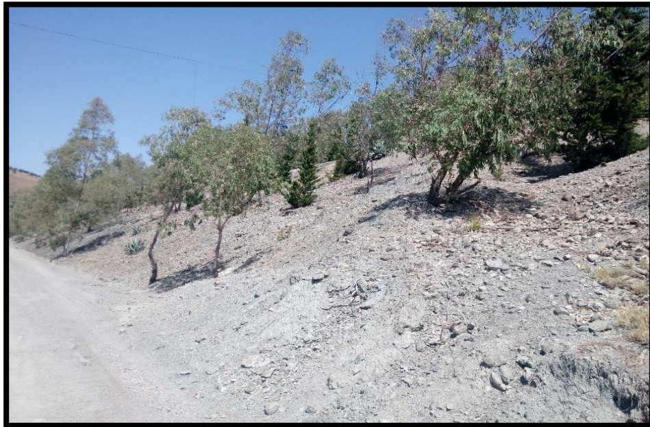
Figure II.17 : Érosion des talus
