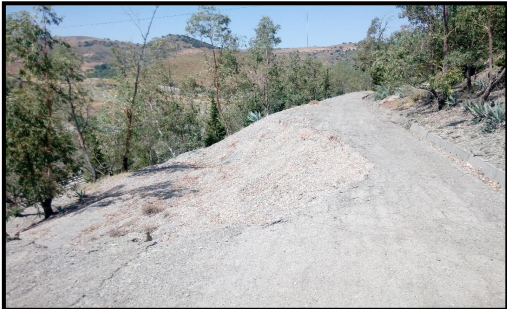
Figure II.19 : glissement locale côté Nord
