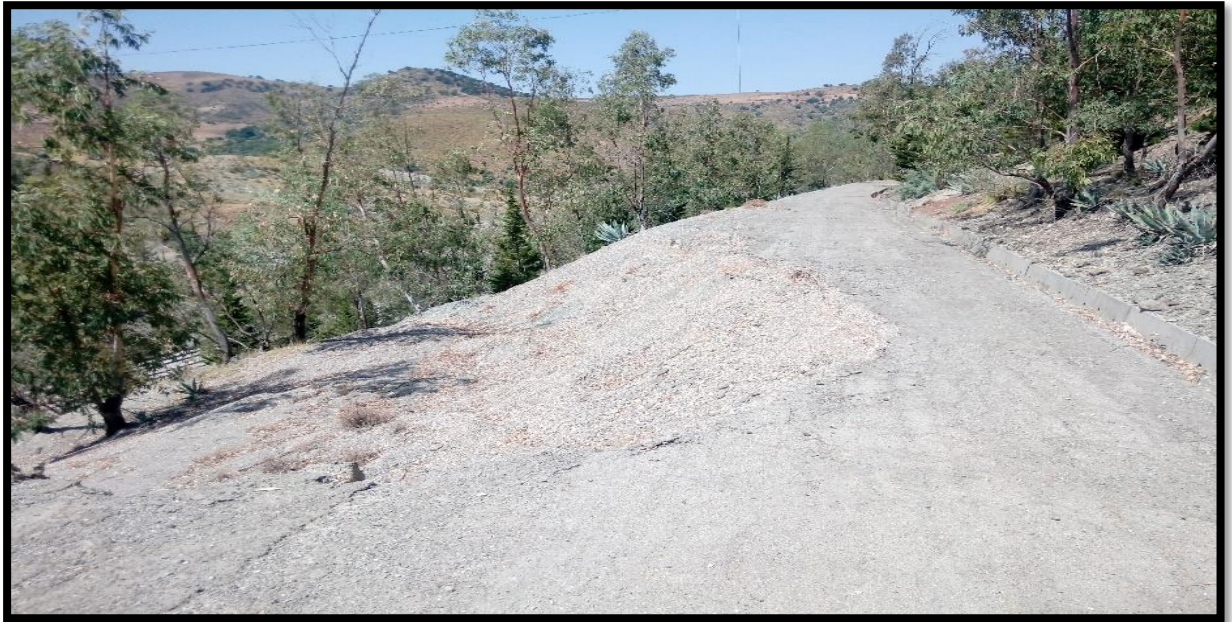
Figure.05 : glissement locale côté Nord
