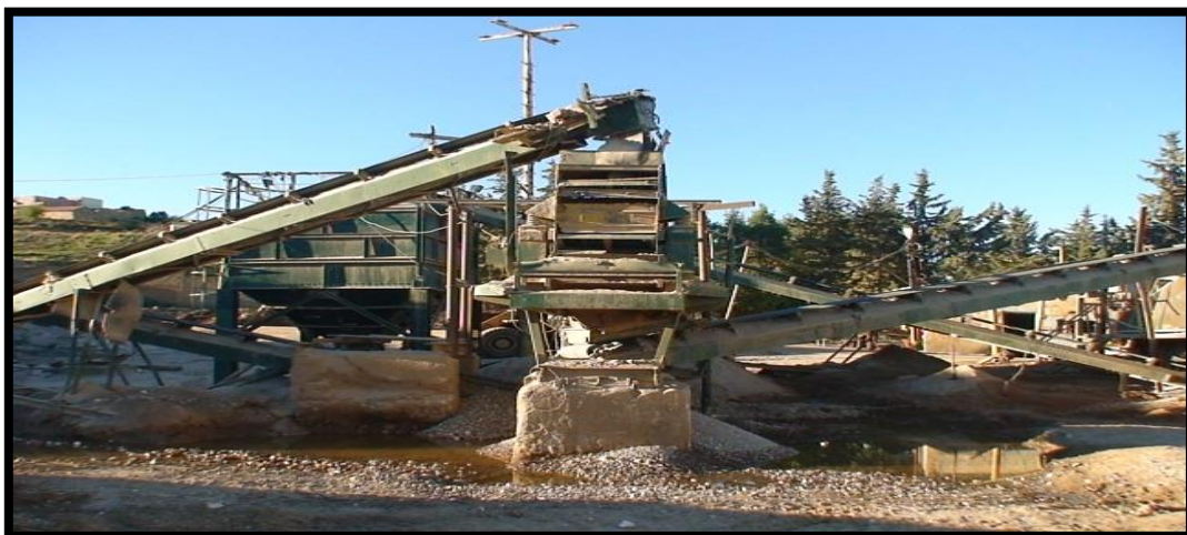
Figure III.04 : Crible vibrant de Ain Mimoun (Mauvais état)
