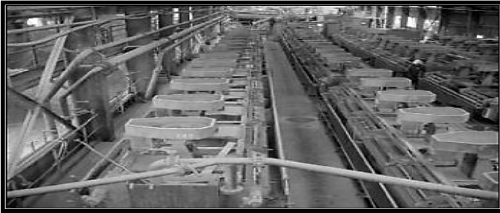
Figure II.03 : Cellules de flottation dans l'usine de Chaillac –France-[02]
