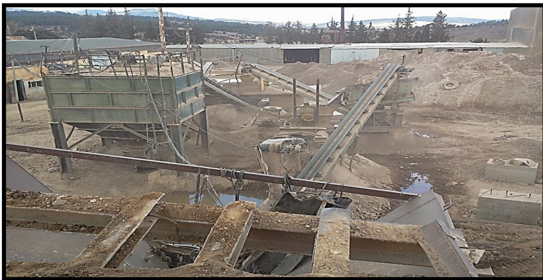
Figure III. 01 : Vue générale de la station du traitement actuel de Ain Mimoun
