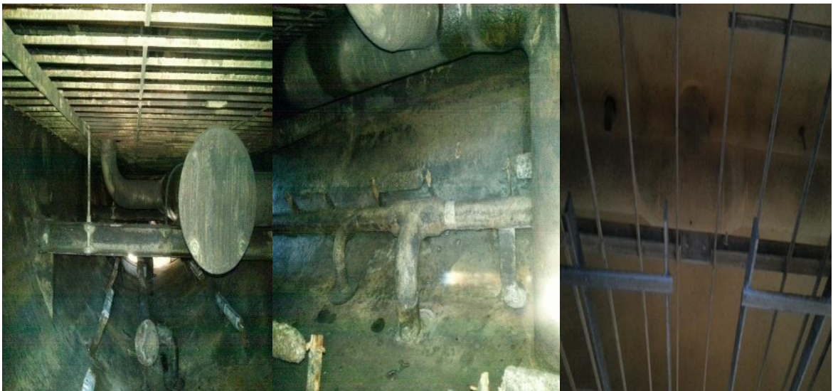
Figure III-4 : Les tuyauteries du dessaleur en arrêt pour le nettoyage [20]
