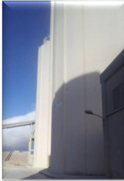
Fig II-08: Les silos d'homogénéisation – cimenterie d'Elma Labioud – TEBESSA -.
