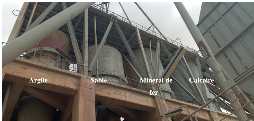
Fig II-06: Les trémies de dosage – cimenterie d'Elma Labioud – TEBESSA -.
