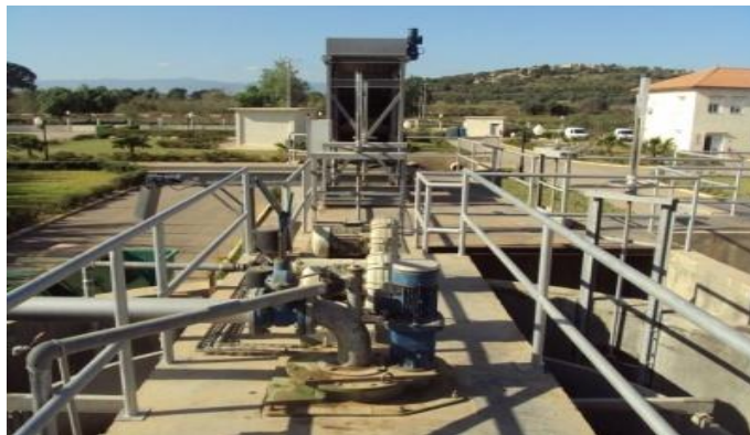
Figure I.13: Etape de dessablage/dégrillage (PP)
