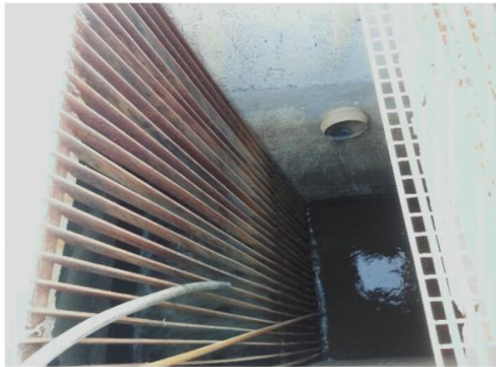
Figure I.11 : Dé grilleur grossier (PP)
