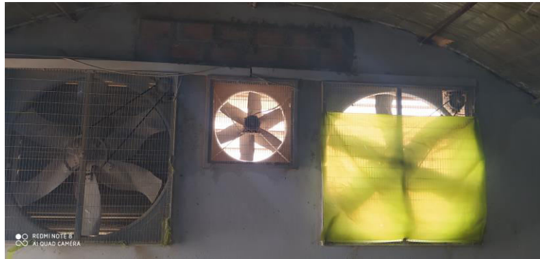
Figure 17 :Extracteurs et ventilateur
