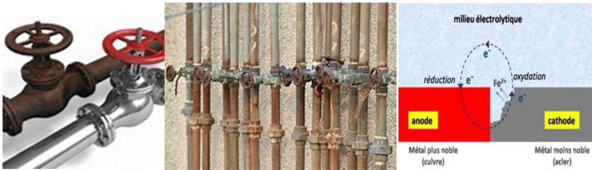
Figure- I. 2. Exemple de corrosion localisé (résultante d'un assemblage de deux métaux différents : robinet en cuivre et conduite en acier galvanisé) L'espace
