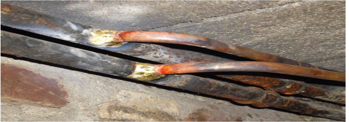
Figure. I.8. Corrosion chimique : Cuivre et acier noir dans une installation
