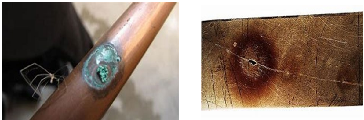
Figure- I.3. Exemple de corrosion par piqure (la paroi d'une cuve en acier inoxydable au sténitique Cr18-Ni10)
