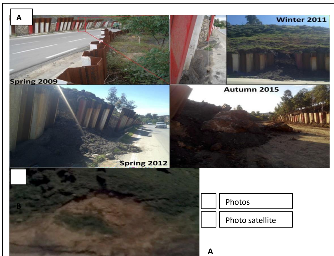
Fig 3.04 : glissements de Mechroha RN 16 Pk81+400.
