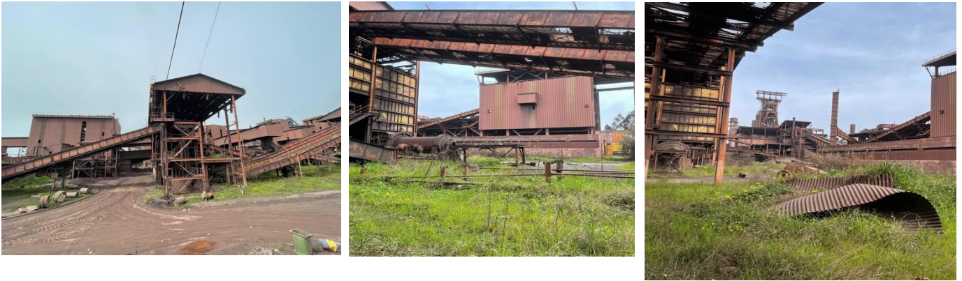
Vue générale de convoyeur à bande (prise de photo)
