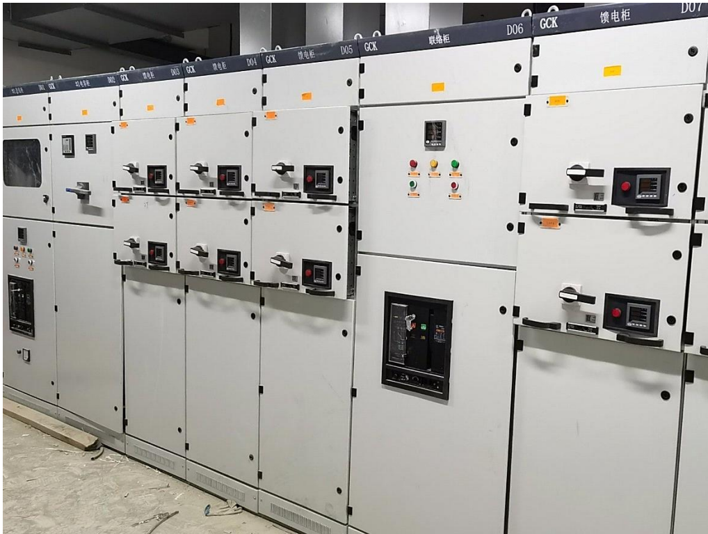
Figure 1.9 : Armoire de distribution d'énergie solaire
