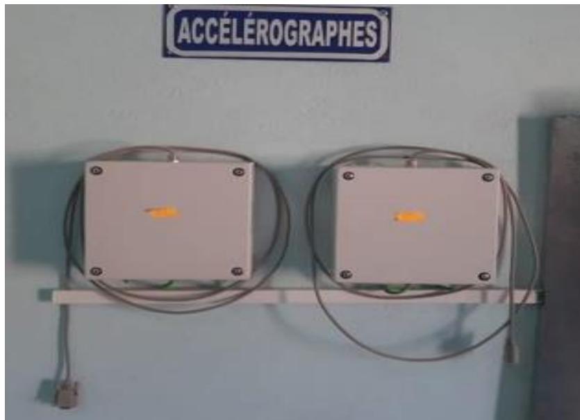
Photos N° 26 : Raccordement des deux (2) accélérographes du barrage d'Ourkiss au niveau du bâtiment de commande.
