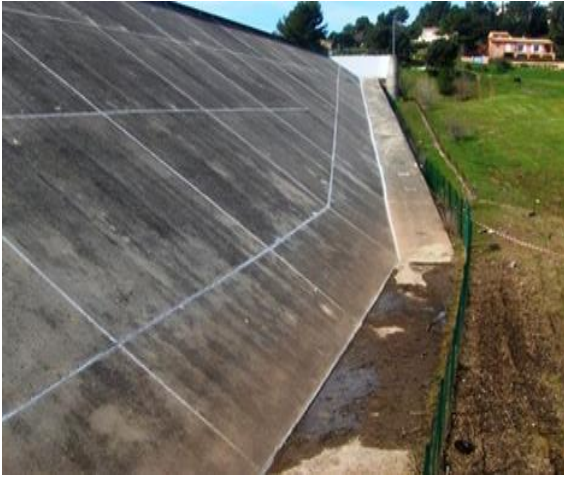
Photo N°5 : Masque en béton armé et plinthe du Barrage des Cous (Photos Irstea-G2DR)
