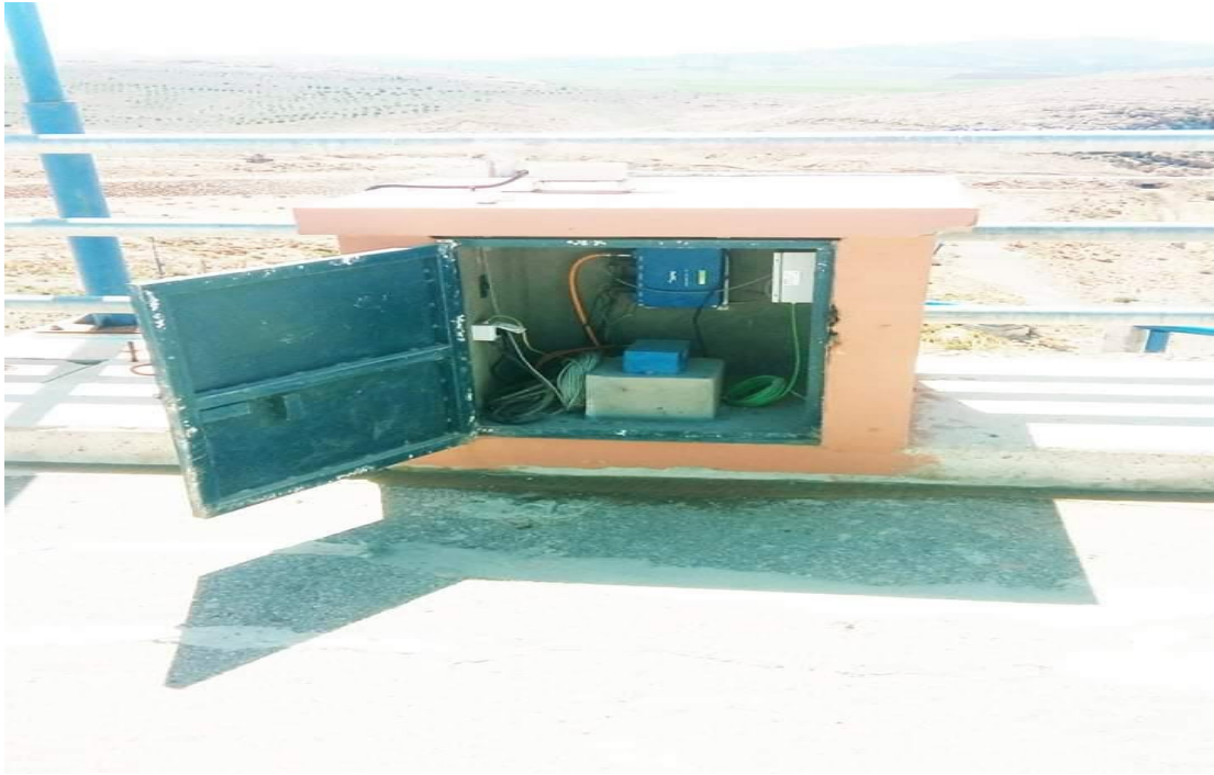
Photos N° 27 : Accélérographe du barrage d'Ourkiss (crête du barrage).
