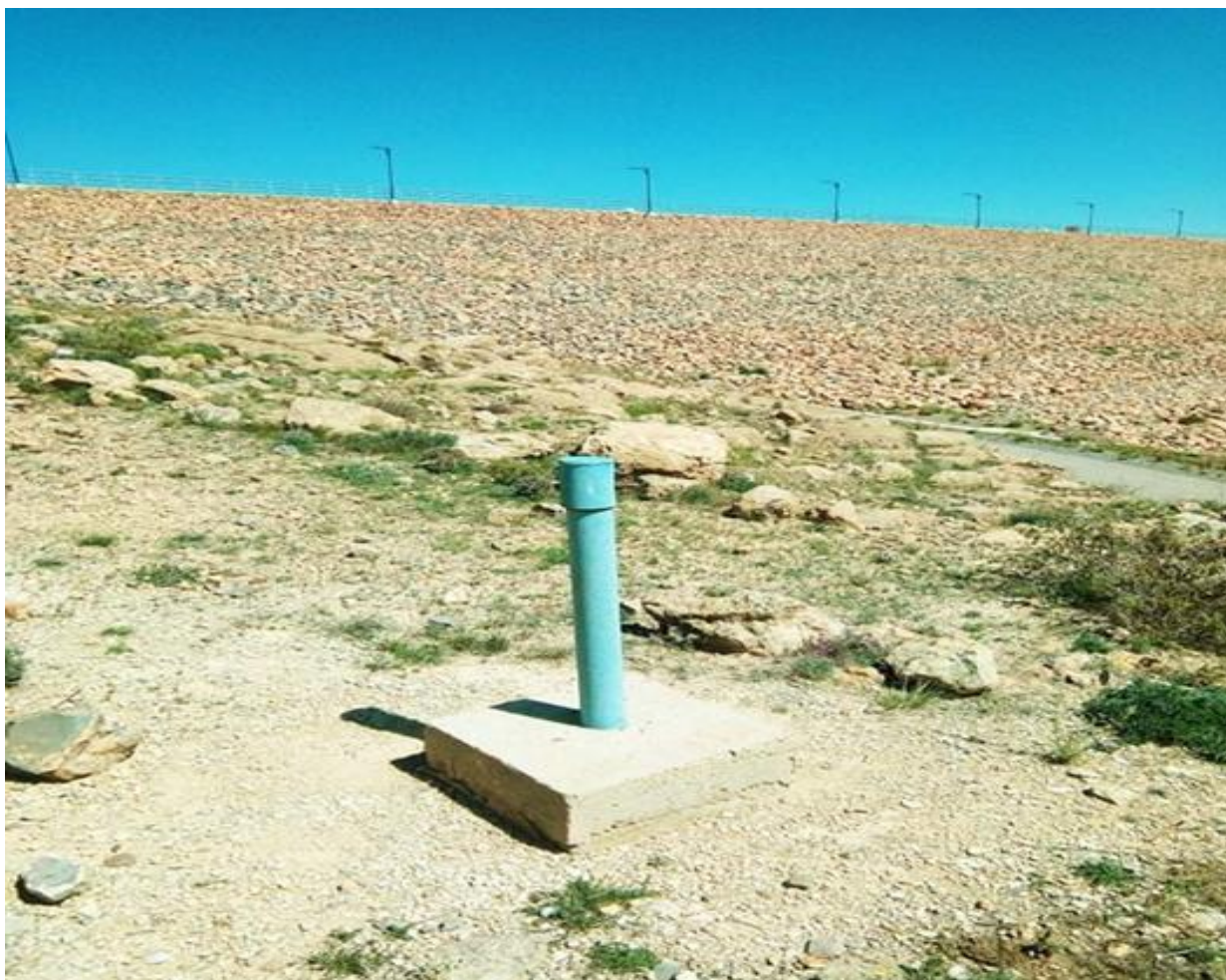
Photos N° 23 : Piézomètre P1 du barrage d'Ourkiss.
