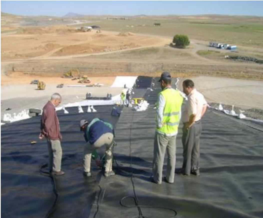
Photos N° 16 : Pose de la géo membrane et géotextile depuis la crête la digue du barrage d'Ourkiss (Présentation du barrage d'Ourkiss,2011).
