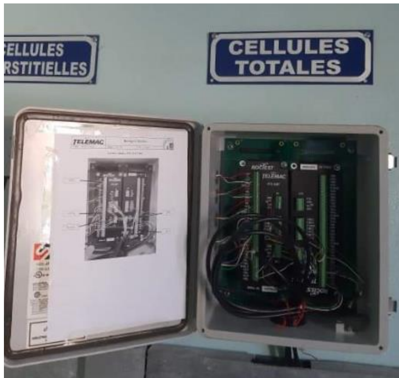
Photos N° 22 : Raccordement des Cellules des pressions totales du barrage d'Ourkiss
