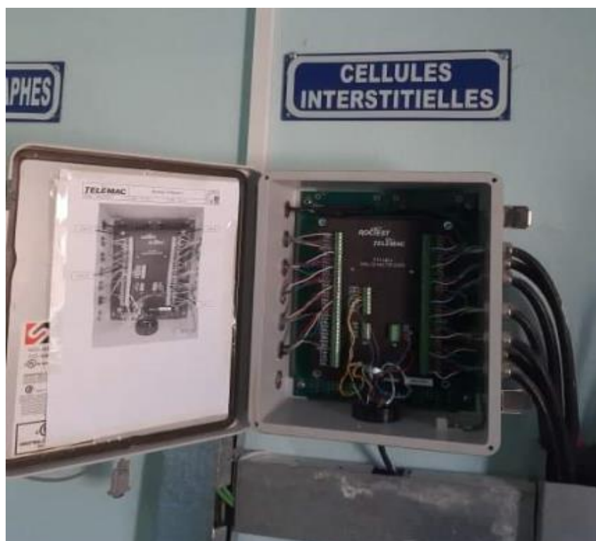
Photos N° 21 : Raccordement des Cellules des pressions interstitielles du barrage d'Ourkiss.
