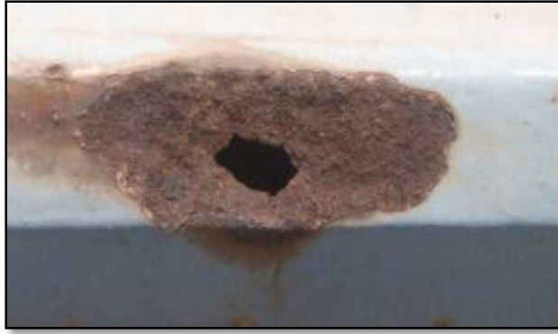
Figure I. 5 : Corrosion par piqûre
