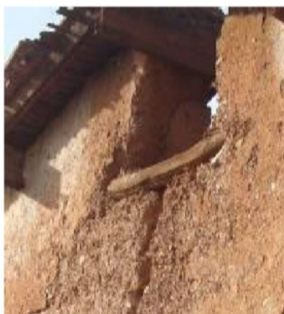
Jambages inexistant et appui en bois.
