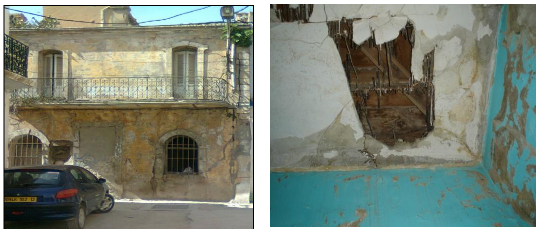
Fig. 32: l'état physique dégradé au niveau des logements de l'intramuros
