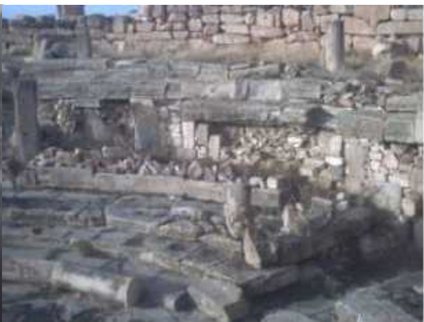
Photo 51 : Manque de pierre de taille, Théâtre de Madaure, Source : auteur, Avril 2016. Source : auteur, Avril 2016.
