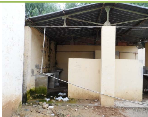
Photo 5 : les sanitaires de l'école (risques liés à la santé).
