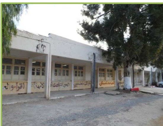
Photo 1 : un revêtement du sol contraire aux normes et aux exigences des écoles.
