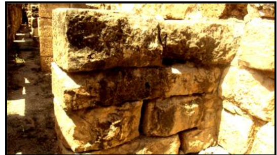
Pierres dégradées (Source –Auteur-)
