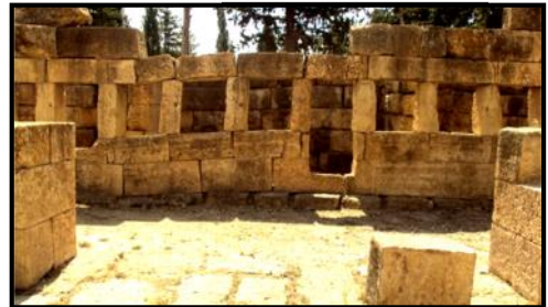
Tassement différentiel au niveau des écuries (Source –Auteure-)
