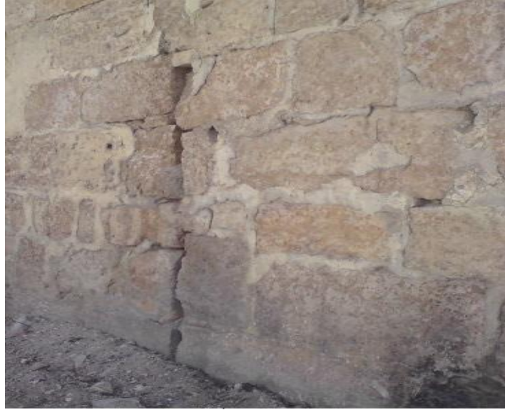
Photo45 : les fissures dans la muraille.
