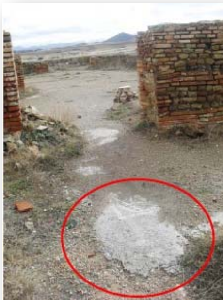
Photo III.9 : Détérioration de la mosaïque par Piétinement (Source : Auteur ).
