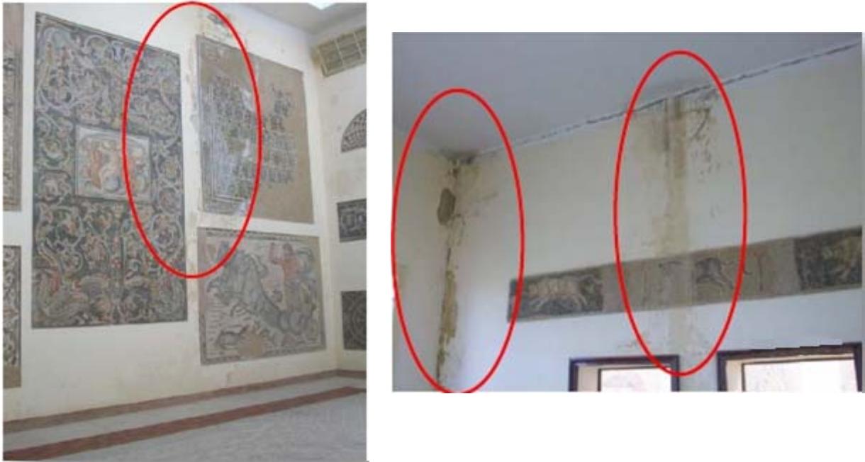
Photo III.16 : Dégradation du musée de timgad (Source : Auteur )
