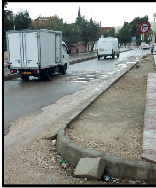
Image n° 13 : l'état des trottoirs.
