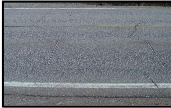
Image n° 06 : Exemple d'une boucle magnétique
