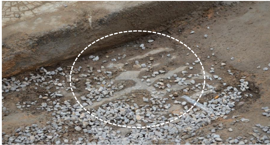
Figure 09 : des déchets solides bouchent les avaloirs (ville de Tébessa).
