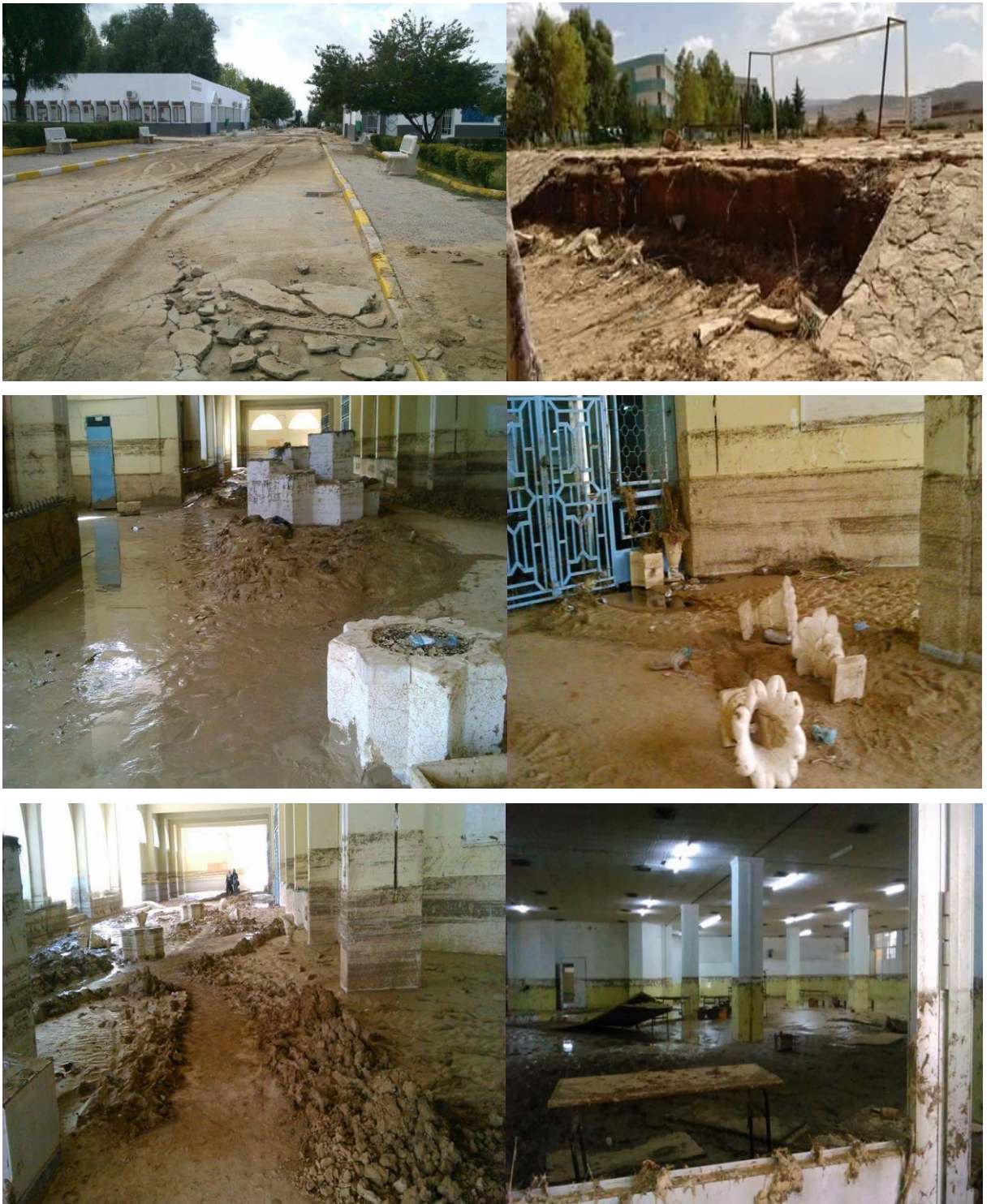
Figure (33 et 34 et 35 et 36 et 37et 38) : Inondation (l'université Larbi-Tébessi). Source: auteur 2015 Tébessa.
