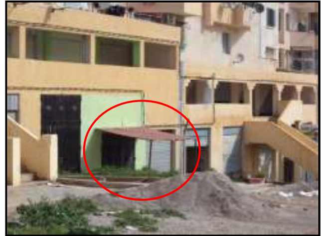
Photo n 86 : une pollution visuelle par un toit additionné
