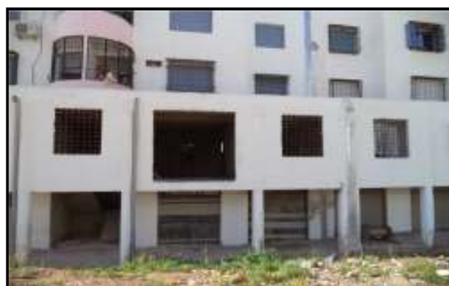
Photo n 53 : une pollution visuelle alarmante par une façade pauvre et négative
