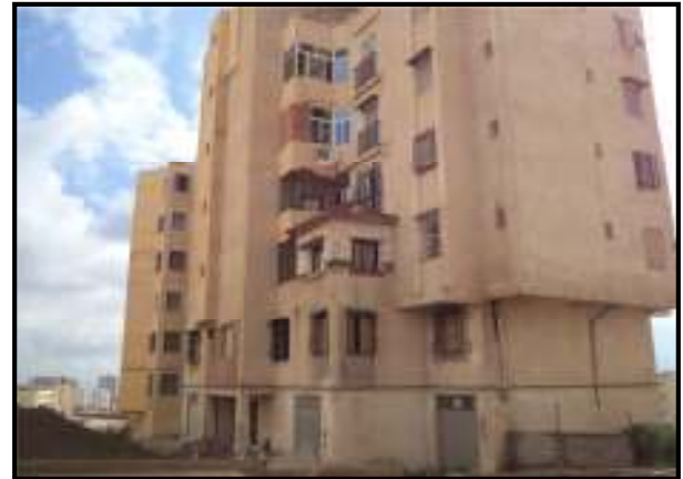
Photo n 63 : Dégradation de cadre de vie en général
