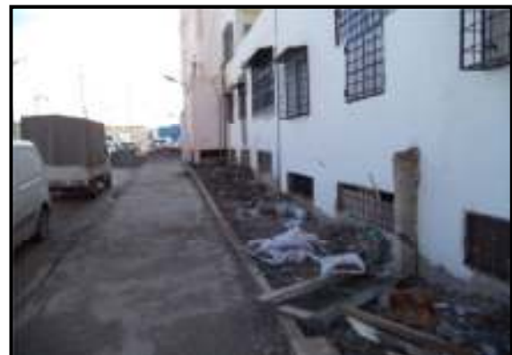
Photo n 76 : une image d'inachevée, de désordre et d'insalubrité
