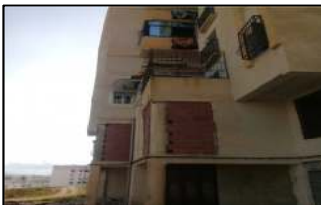
Photo. n°56: inachèvement des façades
