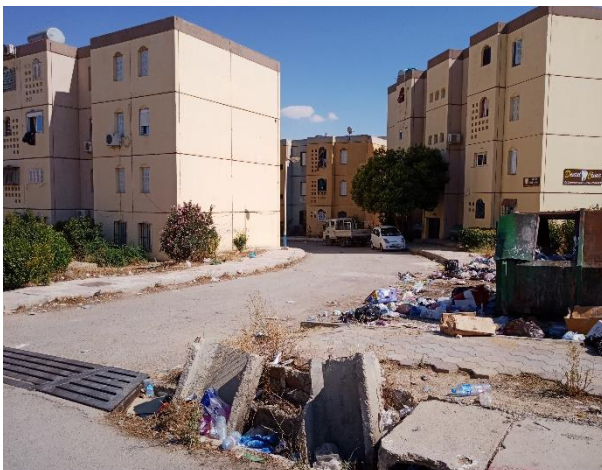
Photo n° 14: Avaloirs dégradé, traitoirs en « état dégradé ». Source : auteur 03/2019.
