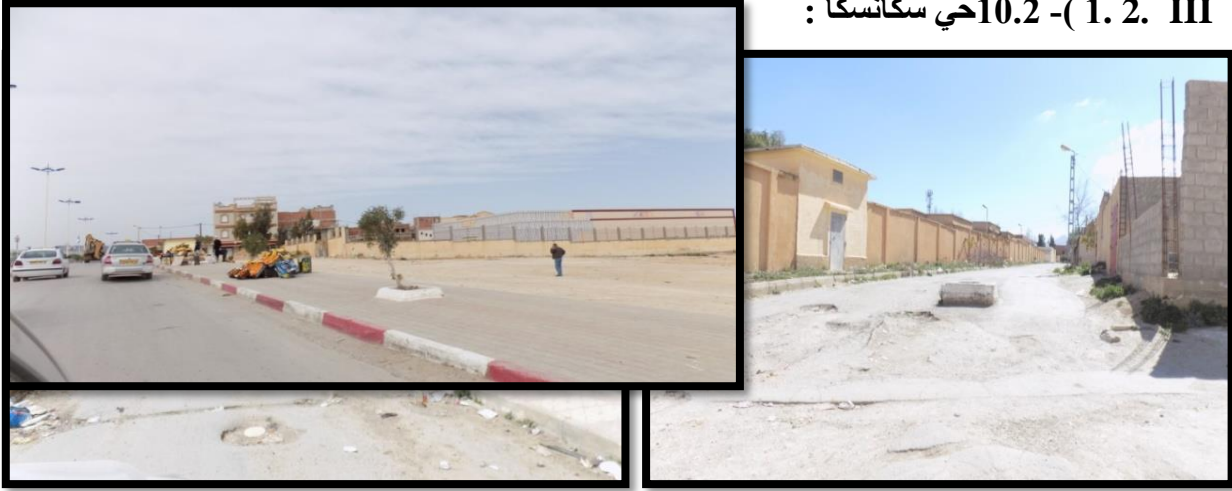
الصورة 139: وضعية شبكة الطرقات والشوارع المتدهورة المصدر : التقاط الطلبة 2019/4/4
