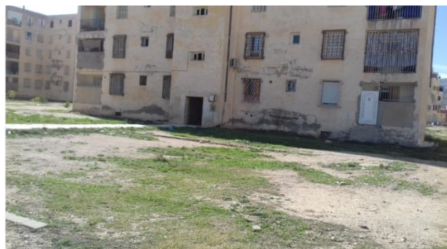
Photo5. 6. Dégradation des paysages (source auteur).
