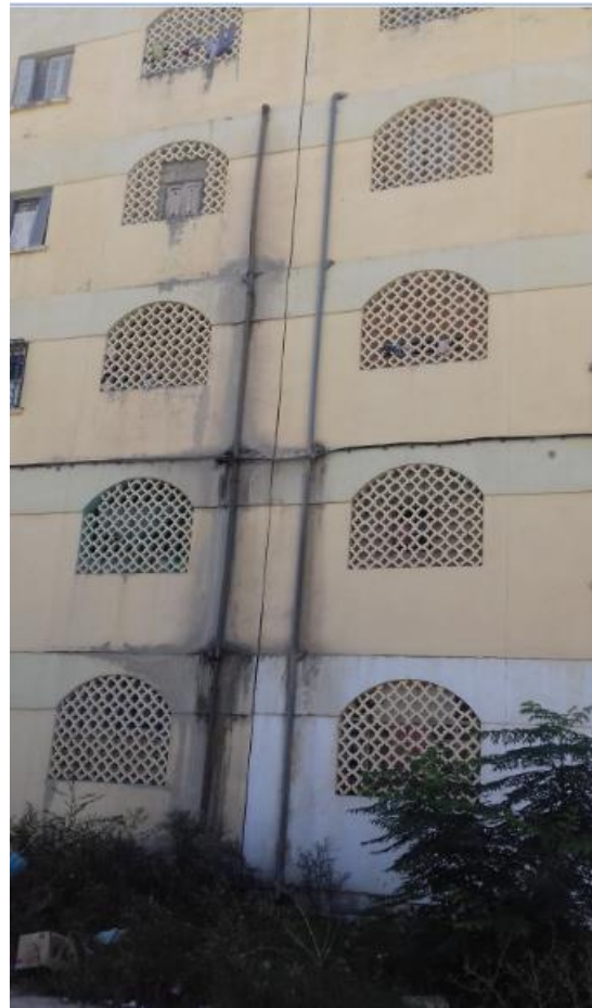
Photo5. 14. Une dégradation au niveau du réseau d'assainissement (source auteurs).
