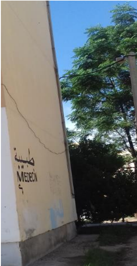
Photo5. 15. Une dégradation au niveau du réseau d'assainissement (source auteurs).
